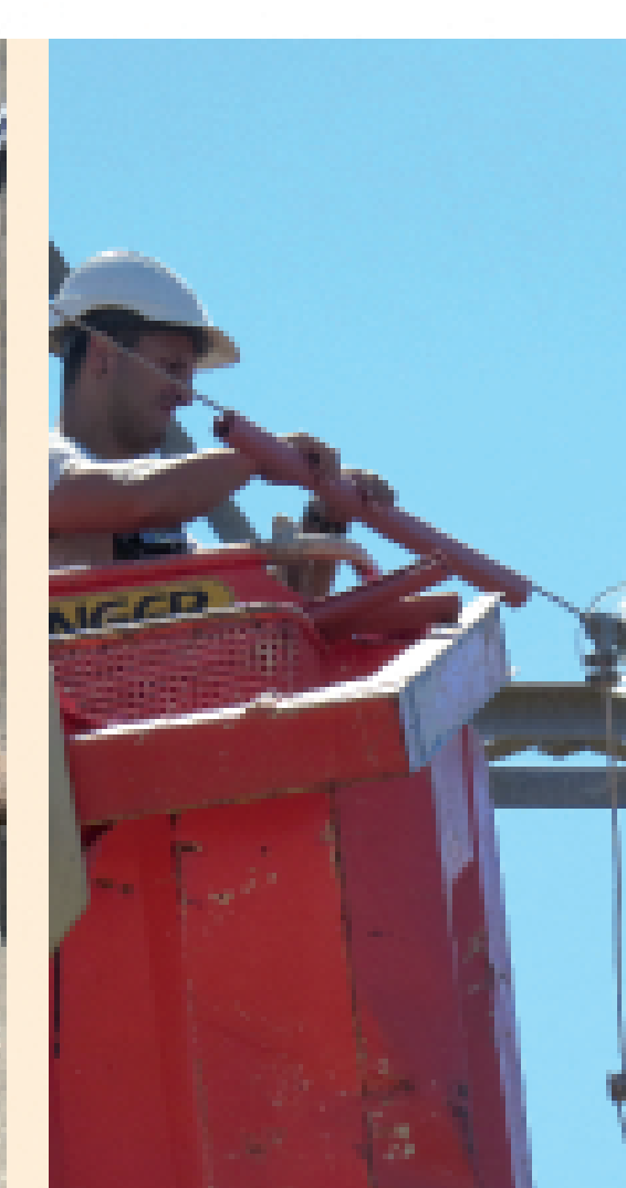
Diagnóstico de la electrocución de aves y corrección de infraestructuras eléctricas peligrosas.
